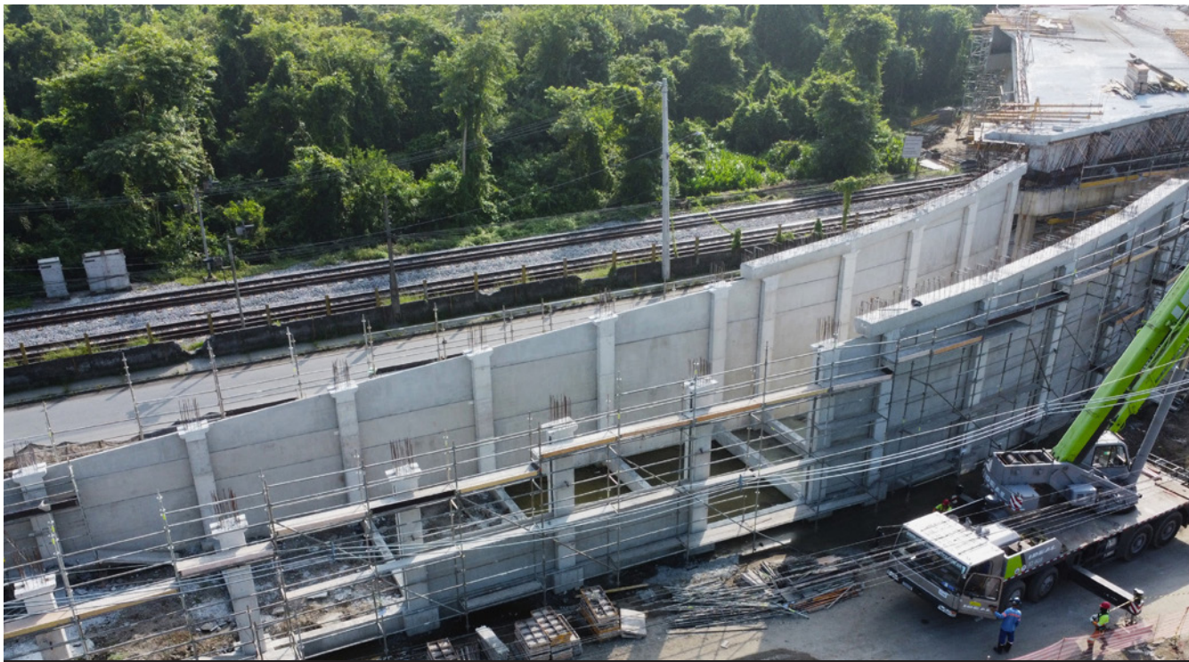
O viaduto de acesso da Vila dos Pescadores - Km 008+300 - Cubatão - SP teve como desafio inicial o desenvolvimento de uma estratégia para a execução de estacas pré-moldadas em solo mole
