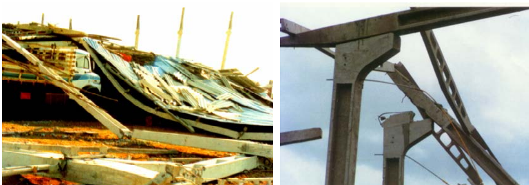
Figura 1.2 - Exemplos de desabamentos de galpões pré-moldados.
