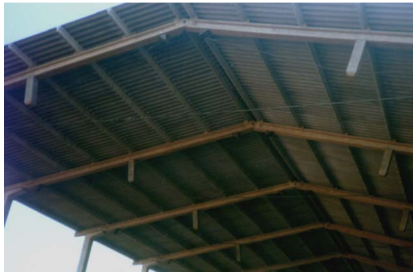
Figura 6.1 - Estrutura com movimentação excessiva - solução adotada.
