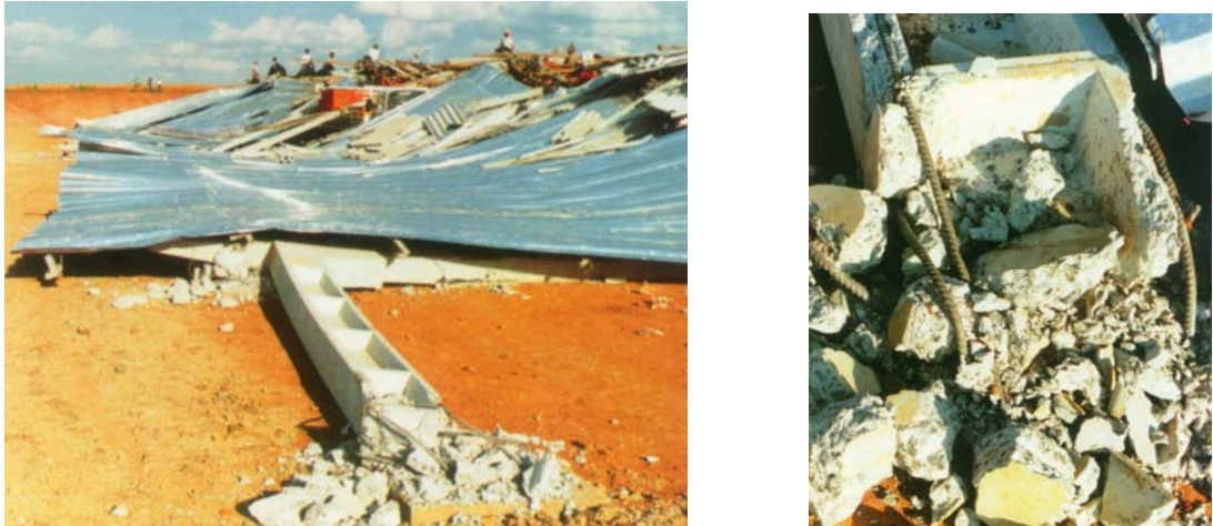
Figura 6.2 - Desabamento de um galpão pré-moldado.
