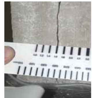
Figura 6.33 – Abertura da fissura.
