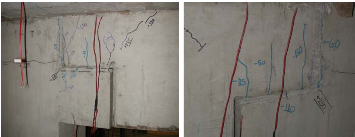
Figura 4.4 - Fissuração do graute e dente gerber do modelo I
