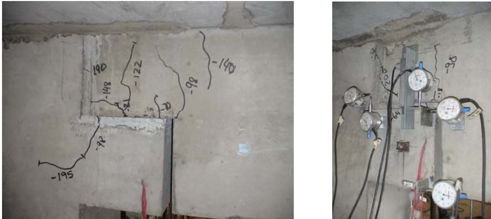
Figura 4.5 - Fissuração do graute e dente gerber do modelo E
