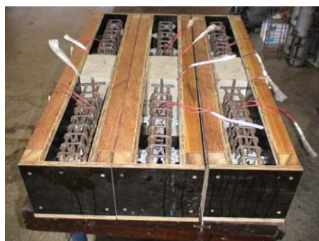
Figura 7.12 - Fôrmas para segunda etapa de concretagem dos modelos P1 SJ e N1 SJ com o trecho de pilar e com as armaduras dos trechos de viga posicionados em seu interior.
