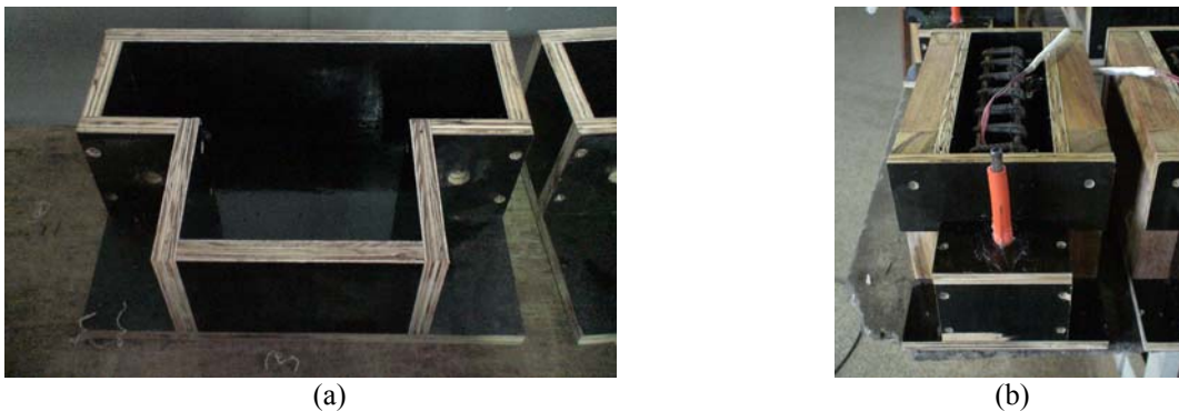
Figura 7.10 - Fôrmas para concretagem dos elementos do modelo de ligação: (a) fôrma do trecho de pilar; (b) fôrma do trecho de viga.
