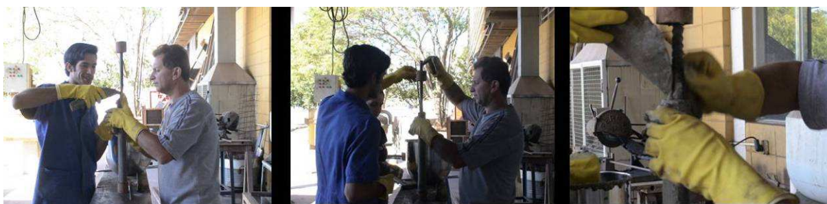
Figura 3.12 – Grauteamento a) Colocação do graute na horizontal, b) Adensamento com vareta e c) detalhe
