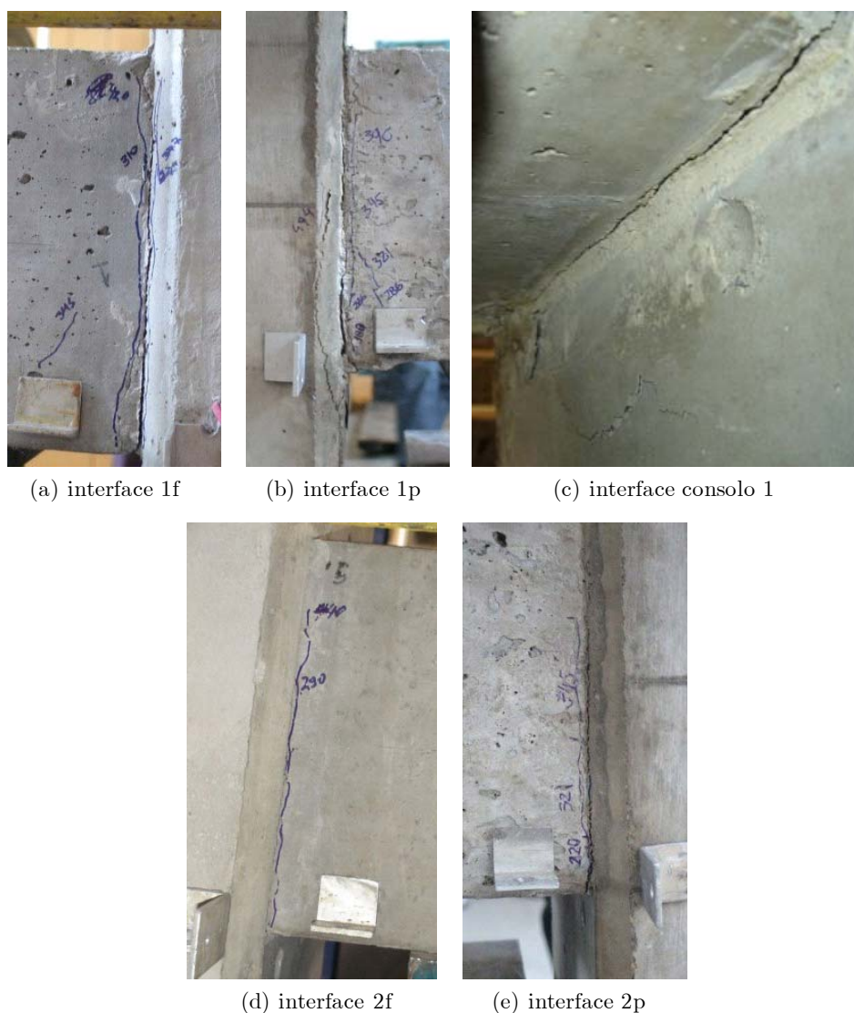
Figura 4.8 - Quadro de fissuração do modelo MBS1.
