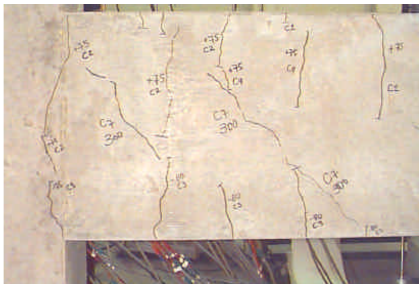
Figura 5.28 – Fissuras no lado direito do Protótipo Monolítico
