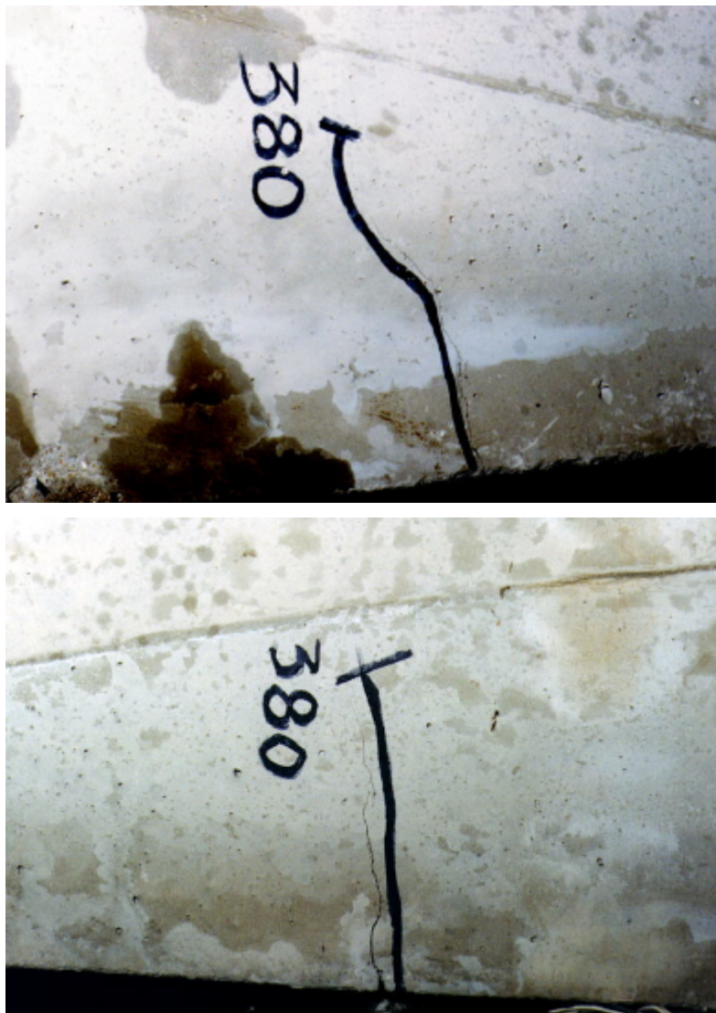
Fig. 8.46 - Configuração da fissuração nas duas faces verticais do dormente sem fibras D14, após 360.000 ciclos de carga e sob a atuação da força estática de 380 kN.
