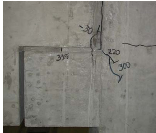
Figura 4.84 – Fissura na almofada de apoio ( F = +315\text{kN} ).
