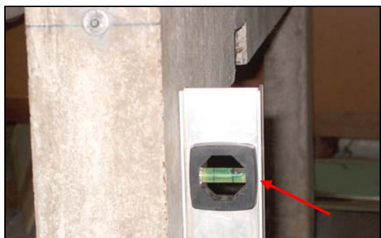
(a) - Pórtico fora de prumo (vide marca da bolha de água)
