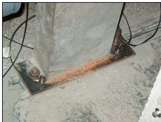
Figura 7.50. Posicionamento dos acelerômetros na base metálica.
