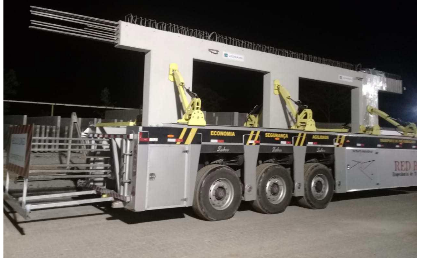
Módulos pré-fabricados “H” — estrutura de contraventamento — 8 pavimentos — concreto fck de 60 a 90 MPa
