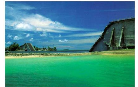
Perda de protensão evidenciada após 18 anos 50%
